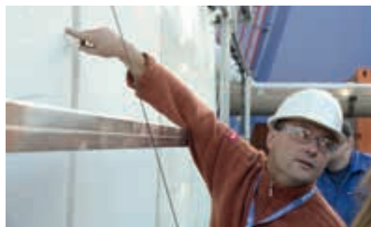
Bei der optischen Beurteilung nach Prüfung durch den sachverständigen Prüfer muss das WDV-System schadensfrei, also ohne Risse sein.
